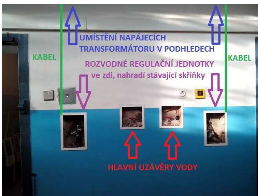
Obrázek 8 – umístění rozvodných regulačních jednotek, transformátorů a napájení
