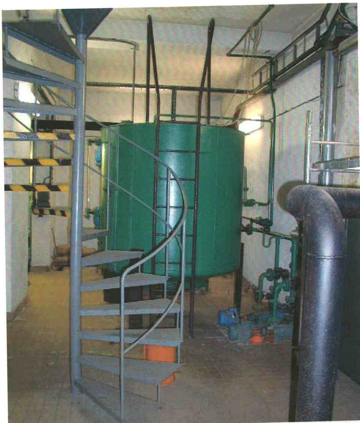
Kotelna - úpravna vody a schodiště k služebnímu bytu
