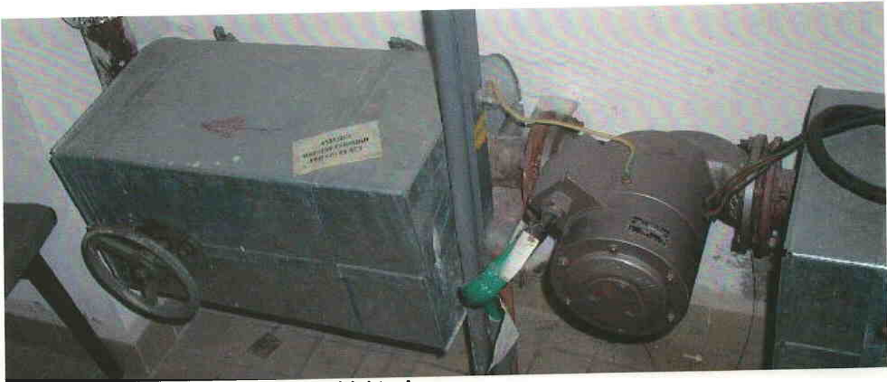
Oběhové čerpadlo TV - kotelna v objektu A
