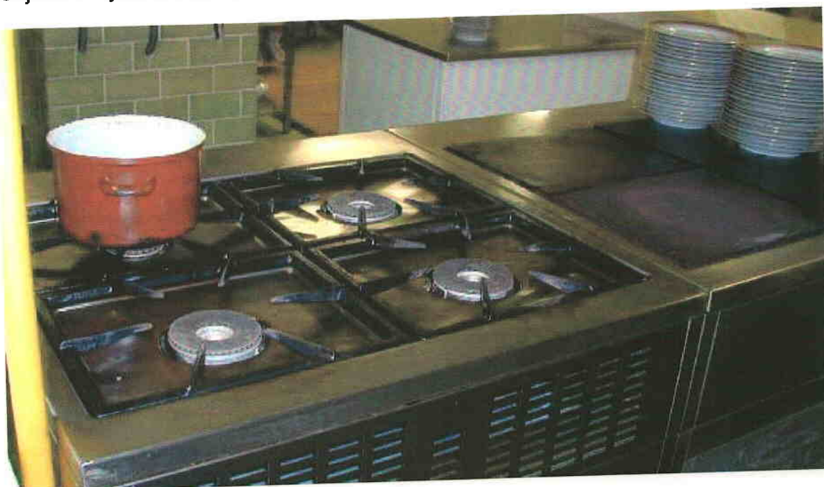
Kuchyně - plynový sporák na PB
