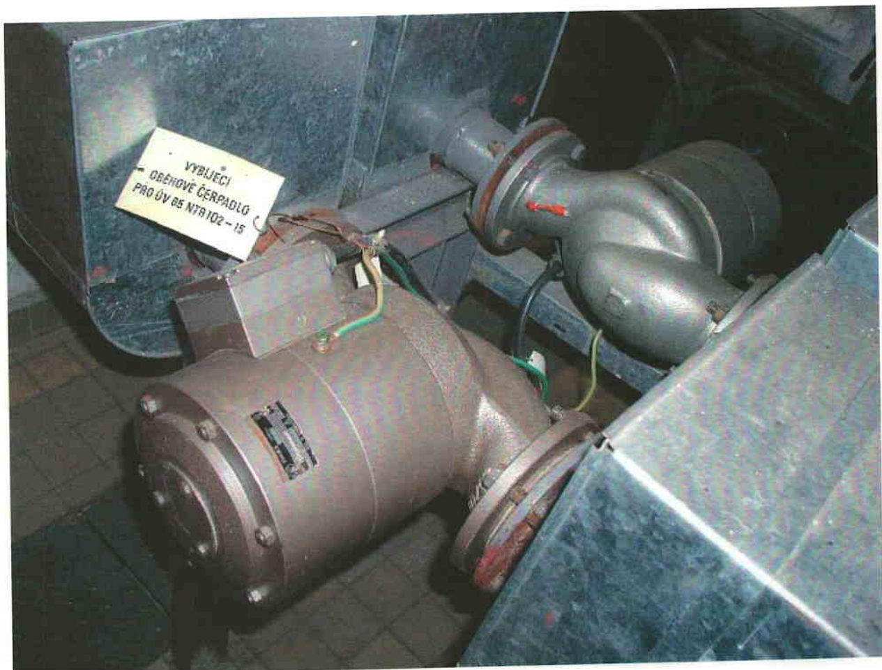
Oběhová čerpadla TV - kotelna v objektu A
