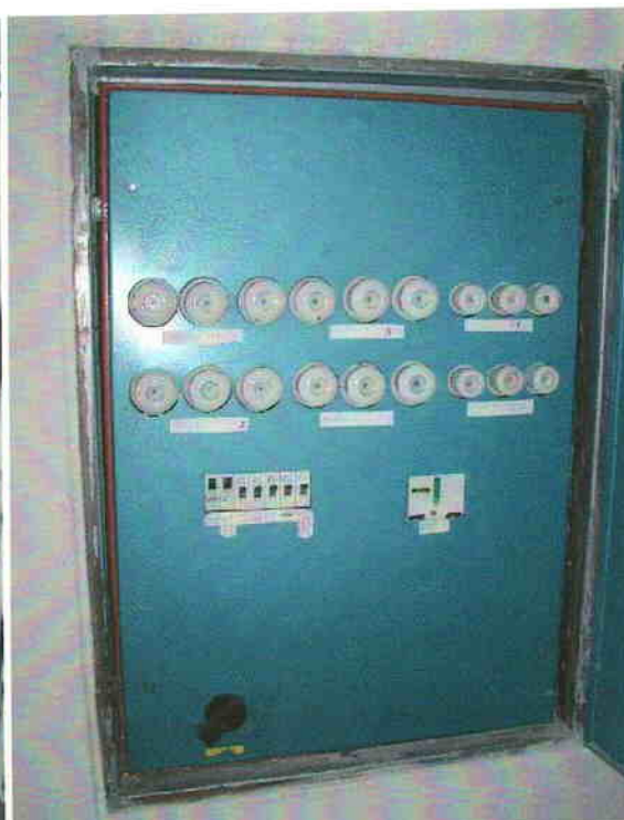
Patrový rozvaděč - objekt A
