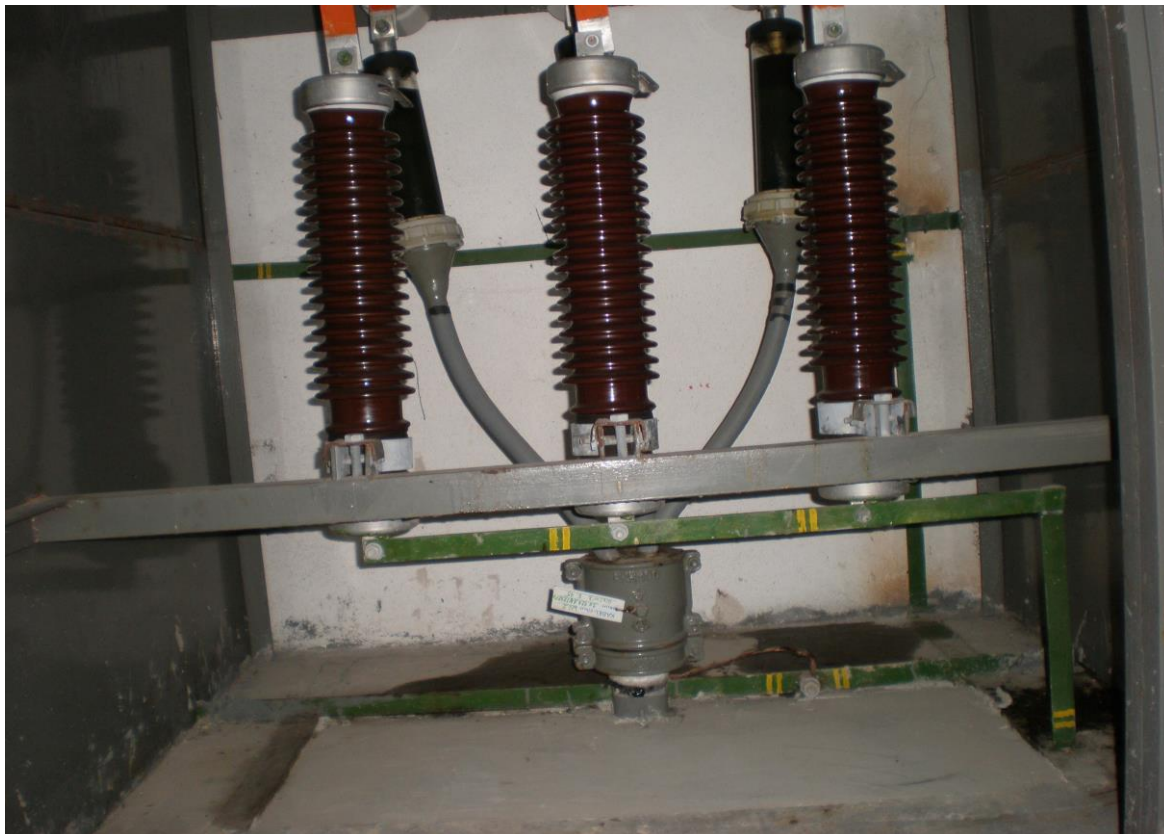
Stávající bleskojistky VA24/10 a vyvedení zemního kabelu přípojky 22kV, typu ANKTOYPV 3x120mm 2
