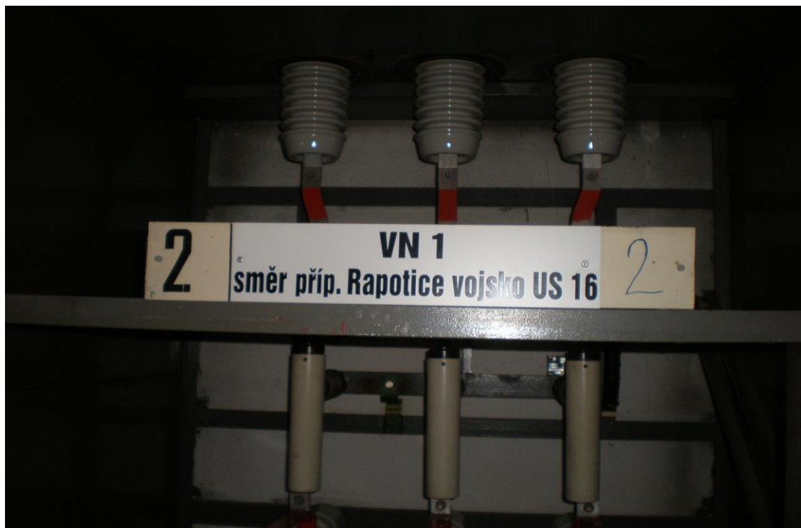
Přípojka vn – kobka č. 2, stávající stav
