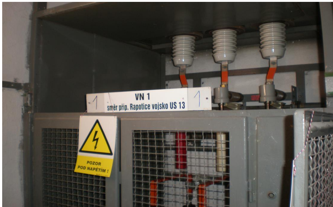
Přípojka vn – kobka č. 1, stávající stav
