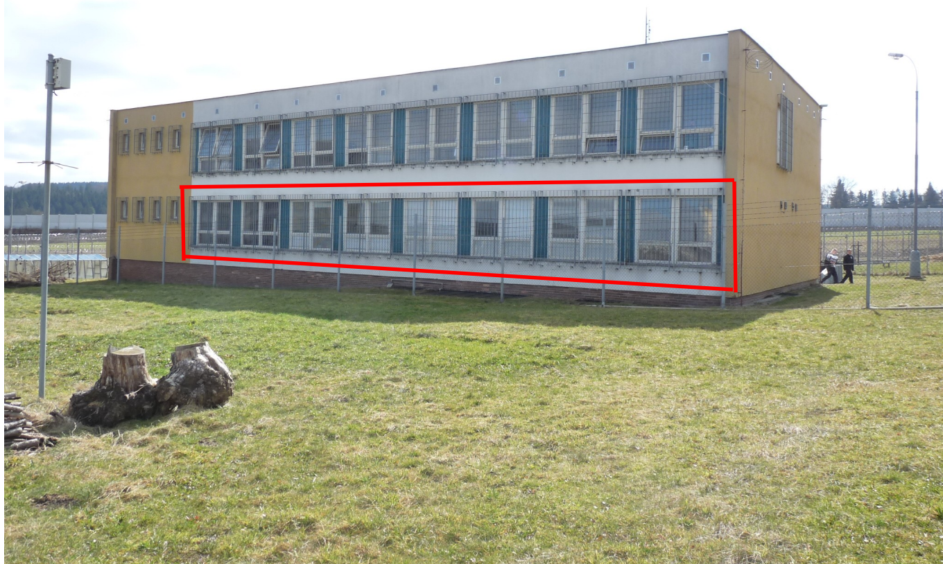
Objekt č. 007 - jižní strana (6 + 4 ks oken k výměně)
