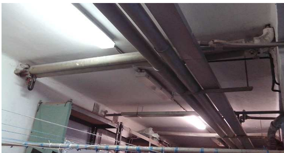
Obrázek 1 - současný stav vedení ústředního topení
