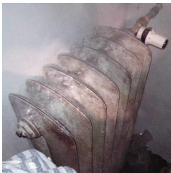
Obrázek 4 – stávající topné těleso
