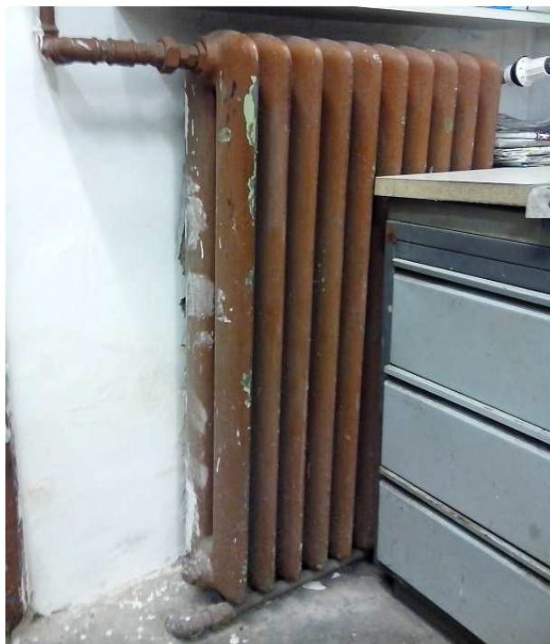
Obrázek 5 – stávající topné těleso
