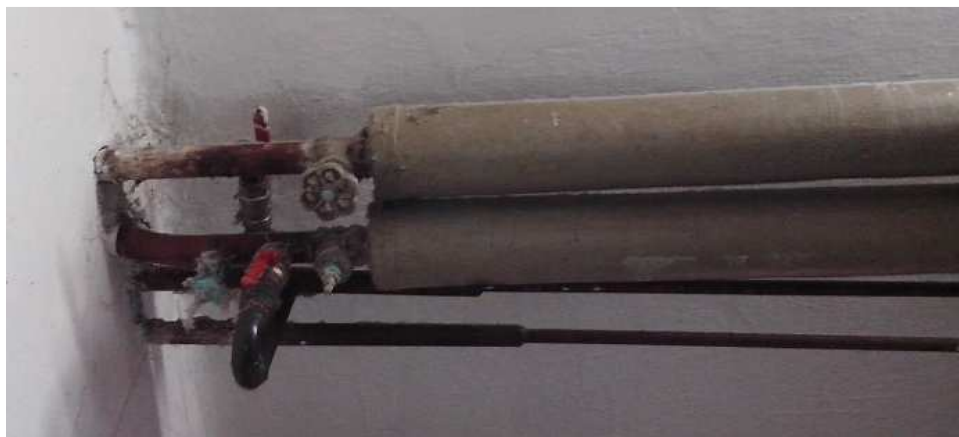
Obrázek 2 - současný stav vedení ústředního topení (s ukázkou nastavování potrubí)
