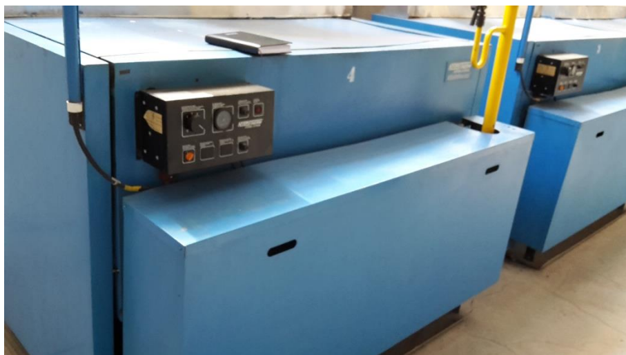
Obrázek 1: Plynové kotle Hydrotherm EV 216/350
